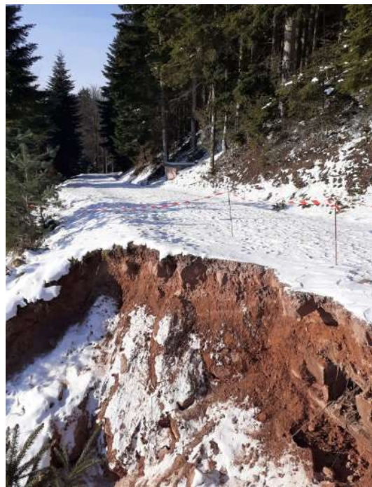
Glissement de terrain La Petite Raon le 1 er février 2021 Photographie DDT 88
