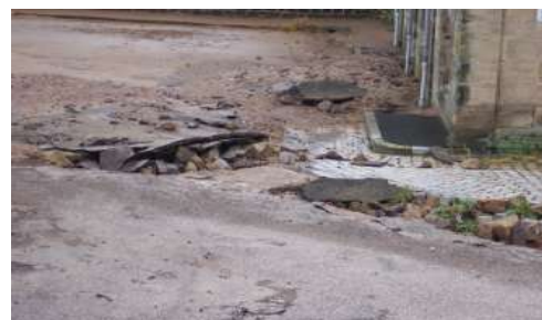
Dégâts de voirie à Darney - 2008 Photographie commune de Darney
